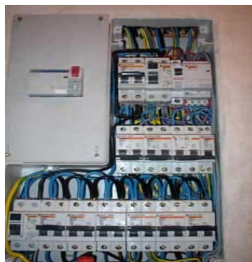
Figura 1. Cuadro eléctrico situado en un lugar peligroso debido al elevado nivel de humedad
